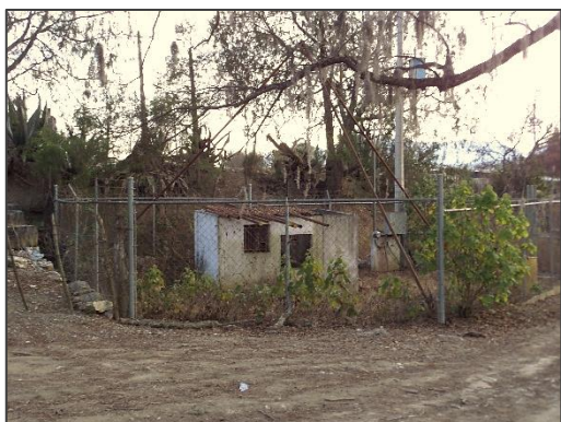
Figura 17. Caseta para bombeo y bomba de diésel
