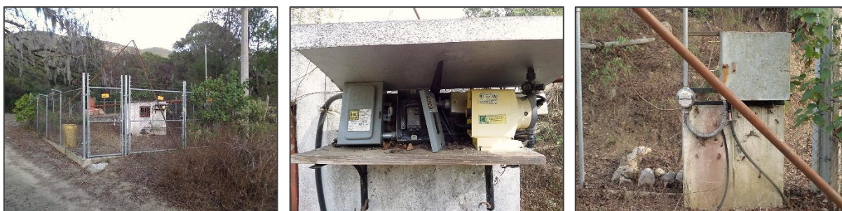
Figura 18. Caseta para bombeo e instalación de bomba eléctrica
