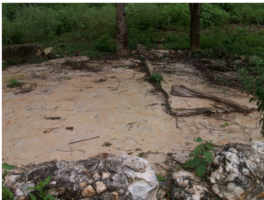
Fotografía 20 Piso de la casa dañada por la inundación
