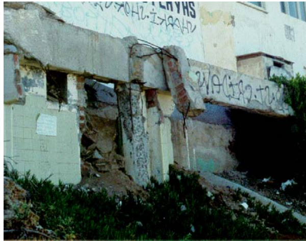
Foto 5.30. Construcción en mal estado
