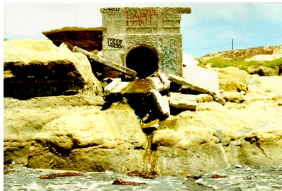
Foto 5.33. Vertimientos de aguas negras
